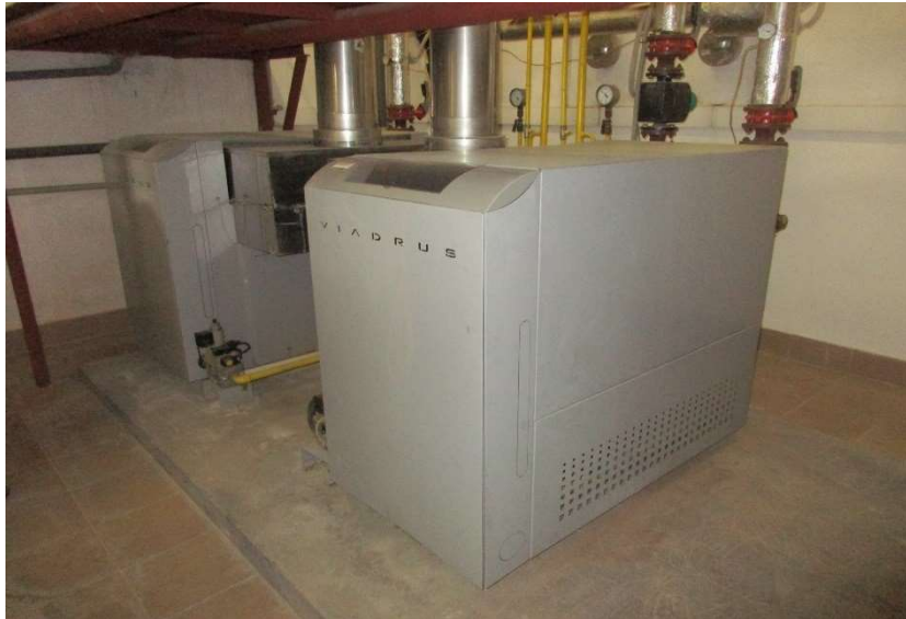
Obrázek 28 Pohled na dva původní plynové kotle Viadrus
