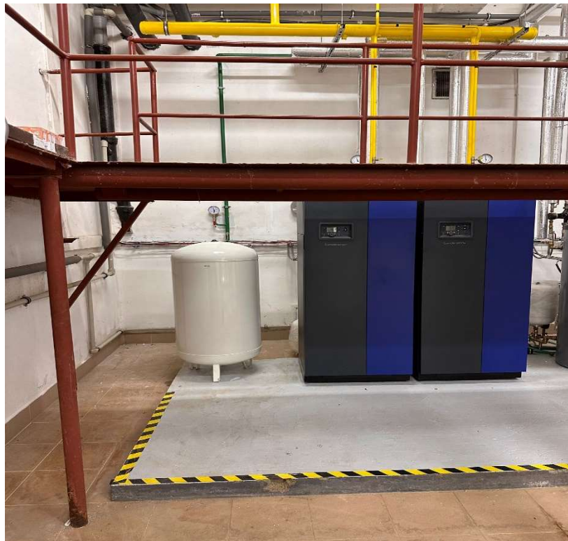
Obrázek 29 Pohled na dva nové plynové kondenzační kotle
