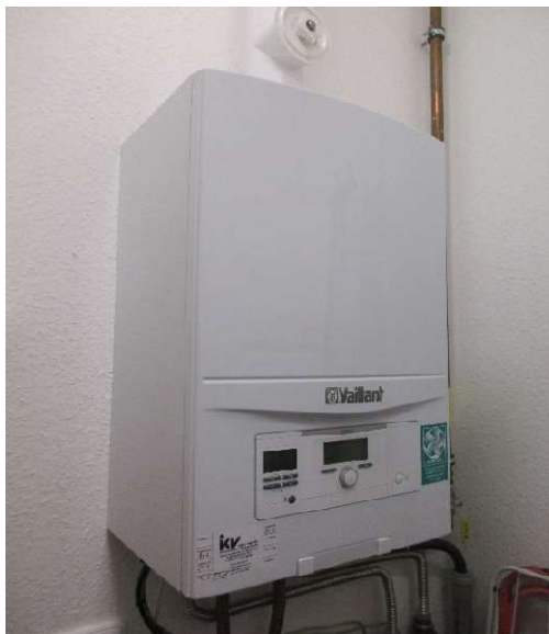
Obrázek 40 Pohled na plynový kondenzační kotel Vaillant
