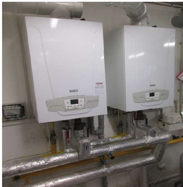
Obrázek 32 Pohled na dva plynové kondenzační kotle Luna Duo-tec
