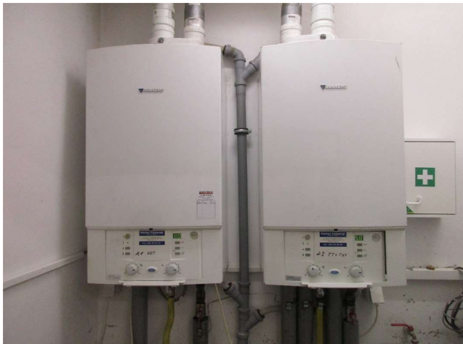
Obrázek 34 Pohled na dva plynové kondenzační kotle Junkers
