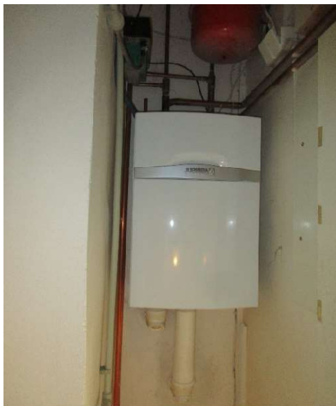
Obrázek 42 Pohled na plynový kondenzační kotel Vaillant
